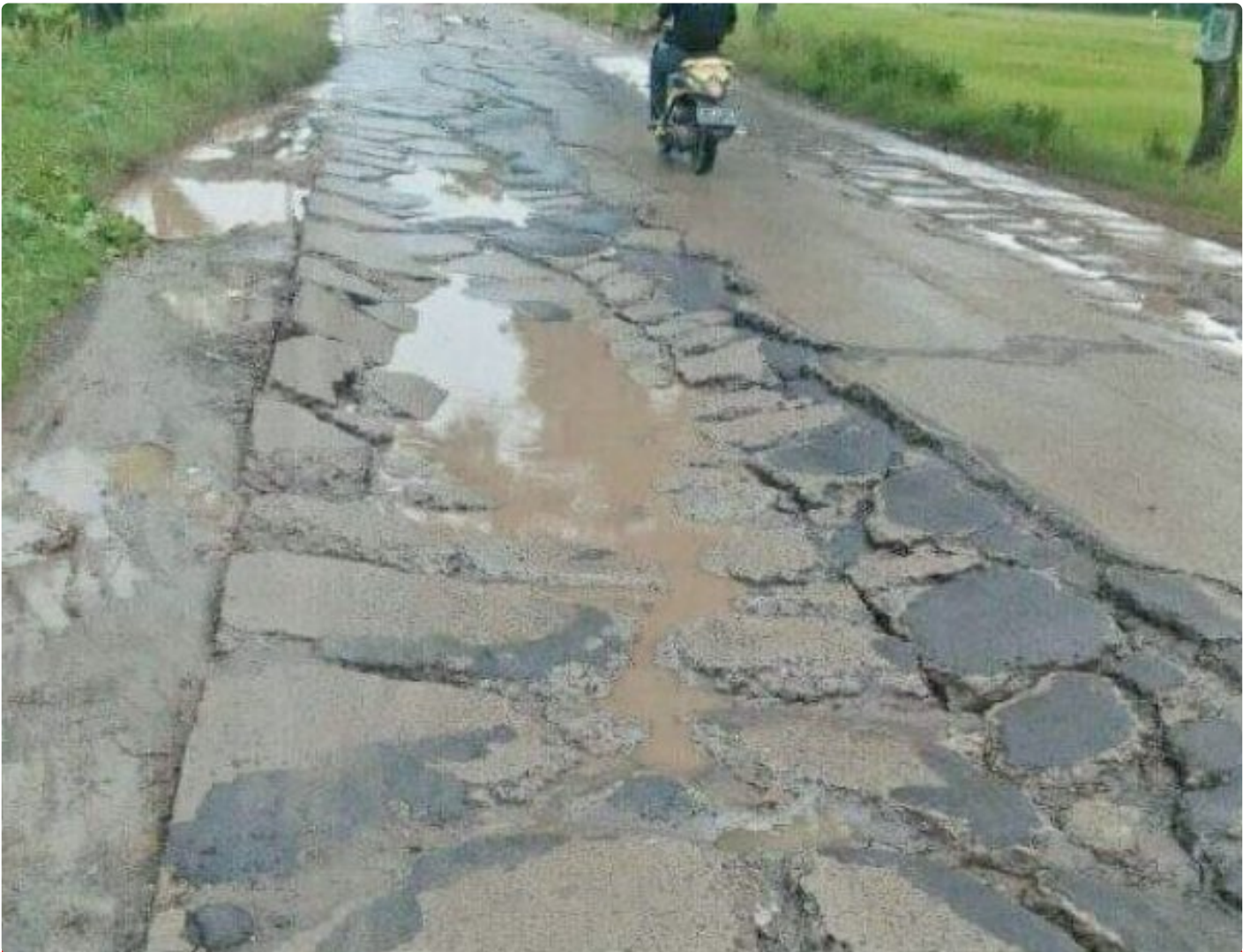
Jalan Beyeh-Simpang yang sudah sangat rusak parah
