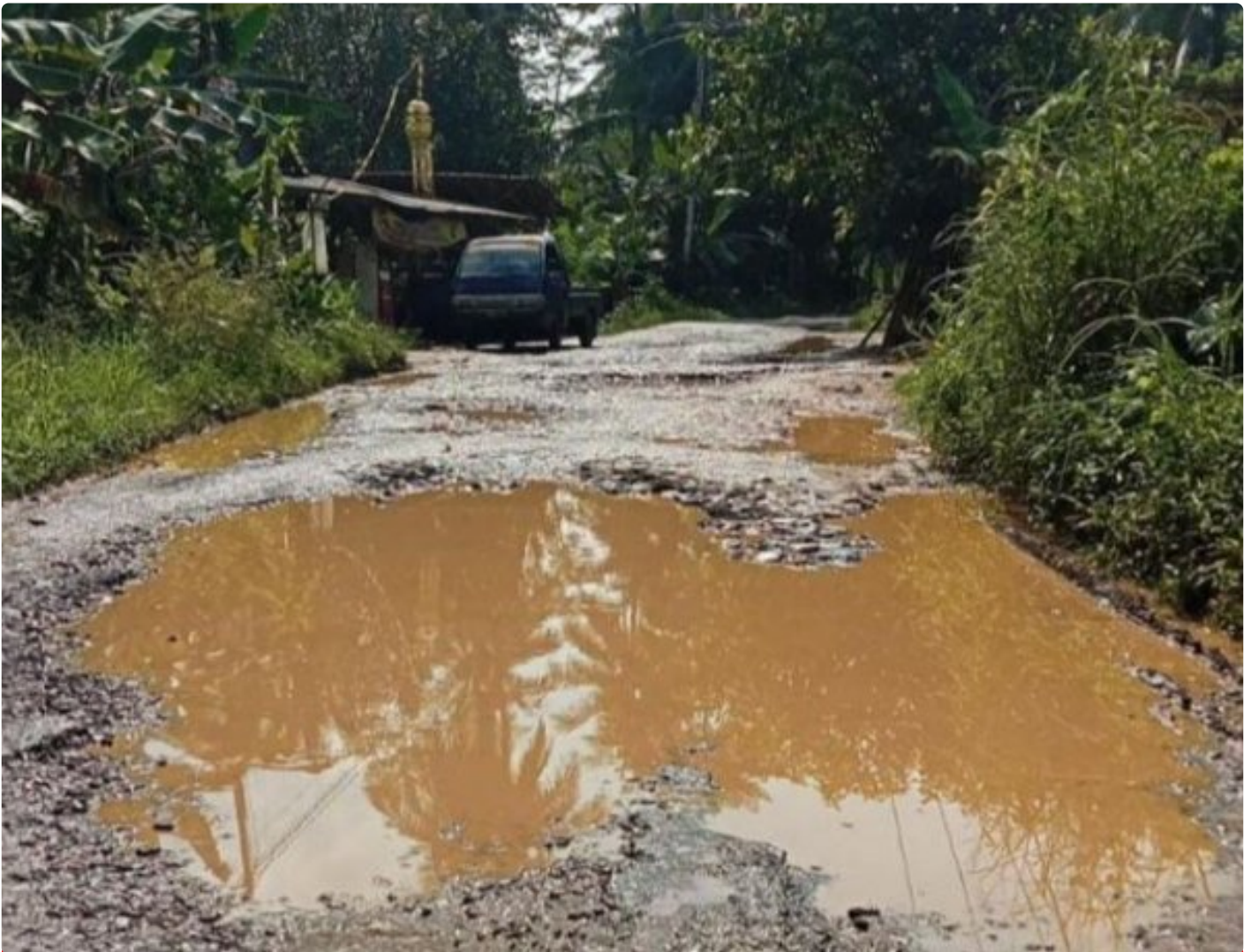
Jalan Jembatan Kayu - Wanasalam rusak parah dan lama dibiarkan
